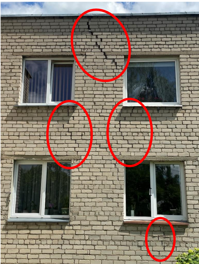
Pav. 8. Sienų defektai: vertikalūs plytų mūro plyšiai
