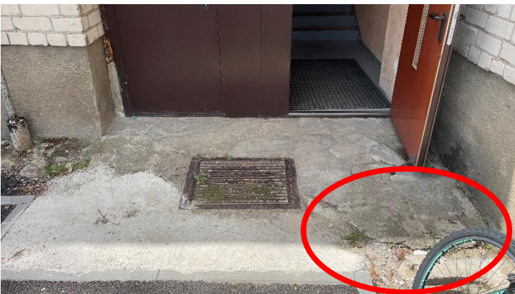
Pav. 13. Įėjimo defektai: aptrupėjęs įėjimo aikštelės betonas
