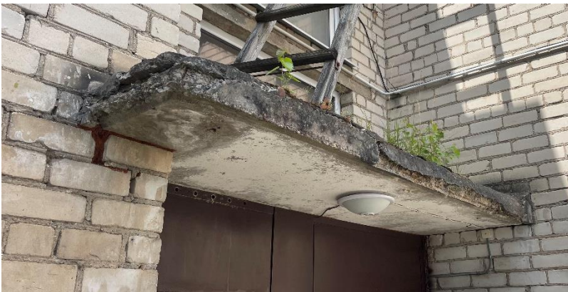
Pav. 12. Įėjimo defektai: ištrupėjęs įėjimo stogelio betonas
