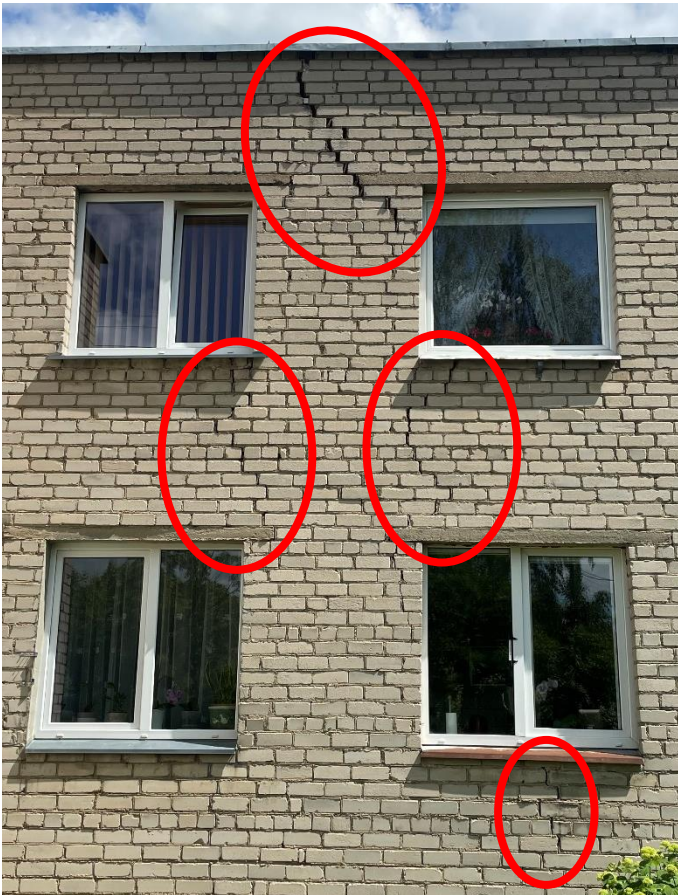
Pav. 8. Sienų defektai: vertikalūs plytų mūro plyšiai
