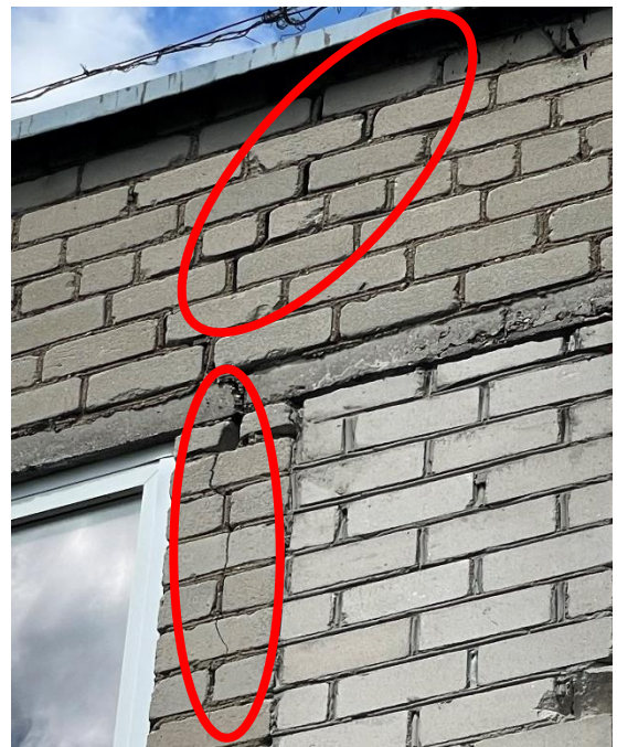
Pav. 10. Sienų defektai: vertikalūs plytų mūro įtrūkimai
