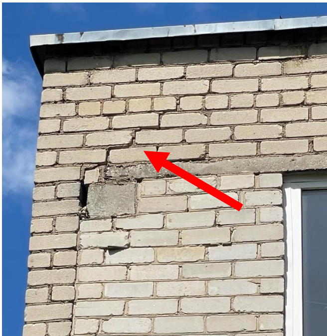
Pav. 9. Sienų defektai: įstriži plytų mūro plyšiai
