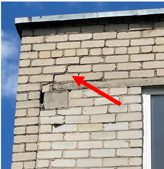
Pav. 9. Sienų defektai: įstriži plytų mūro plyšiai
