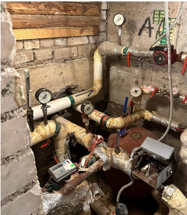
Pav. 15. Komunikacijų vamzdynų būklė
