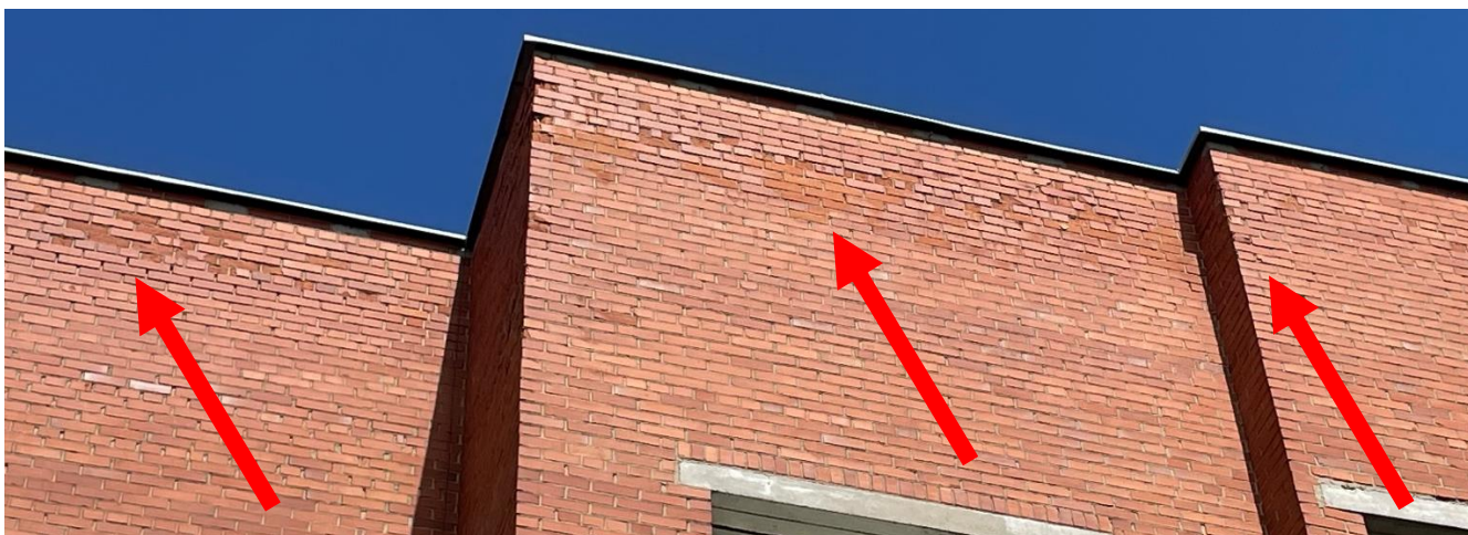
Pav. 11. Sienų defektai: ištrupėjęs plytų mūras
