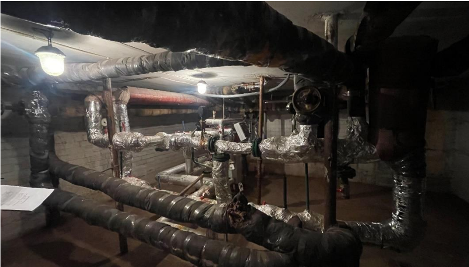
Pav. 19. Komunikacijų vamzdynų būklė
