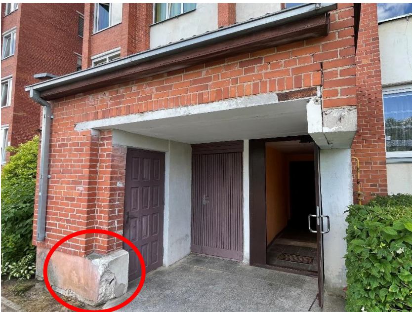
Pav. 18. Įėjimo defektai
