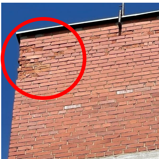
Pav. 12. Sienų defektai: ištrupėjęs plytų mūras
