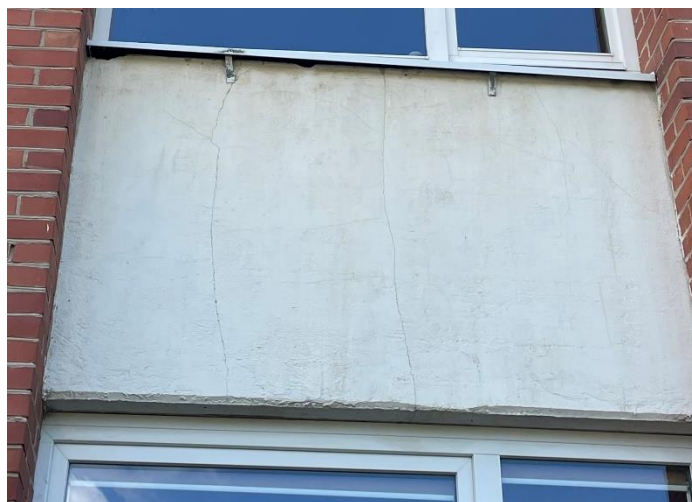
Pav. 15. Sienų defektai: vertikalūs g/b sienų plokščių įtrūkimai
