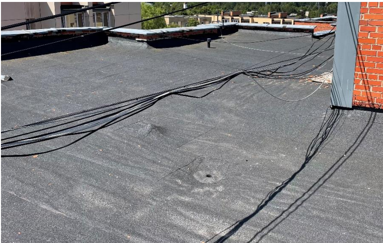
Pav. 16. Stogo defektai: pūslėta danga
