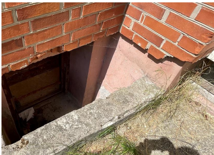
Pav. 13. Sienų defektai: apskilinėjęs plytų mūras
