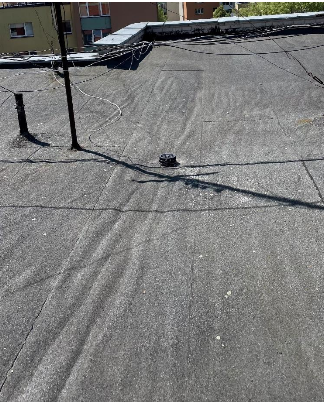
Pav. 15. Stogo būklė: pūslėta danga
