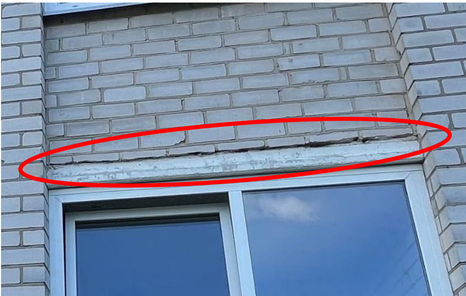
Pav. 13. Sienų defektai: apskilinėjęs plytų mūras
