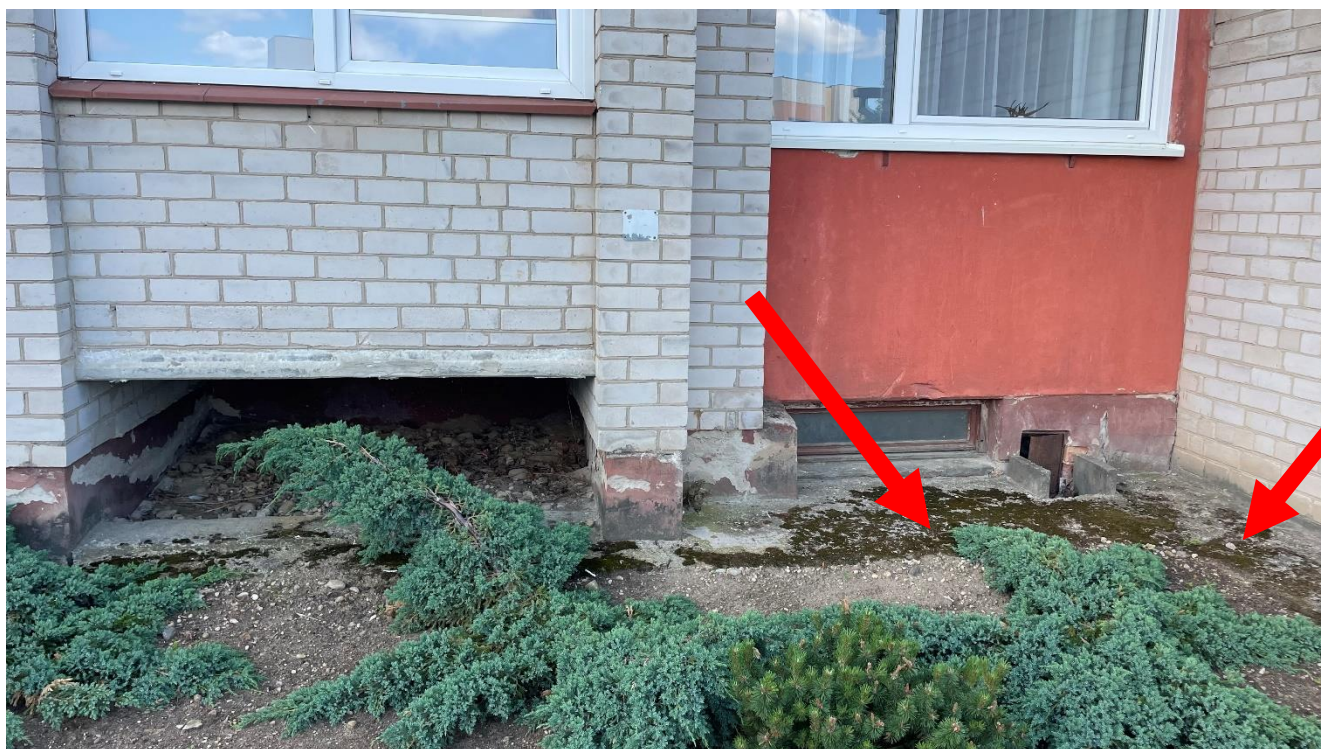
Pav. 11. Cokolio defektai
