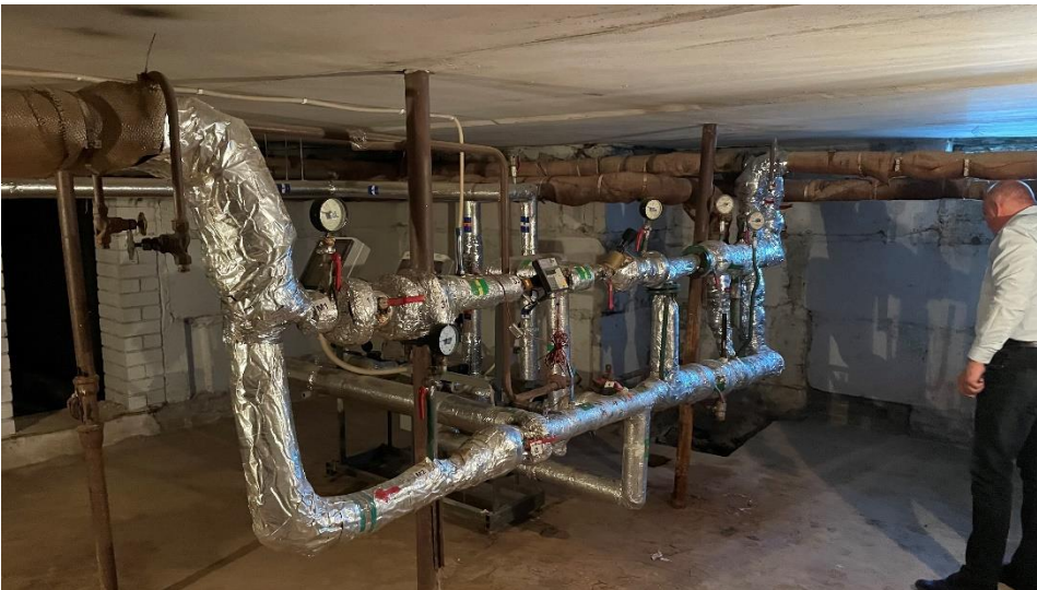
Pav. 19. Komunikacijų vamzdynų būklė
