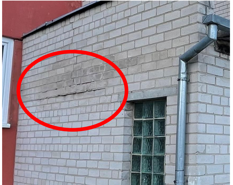
Pav. 18. Įėjimo defektai
